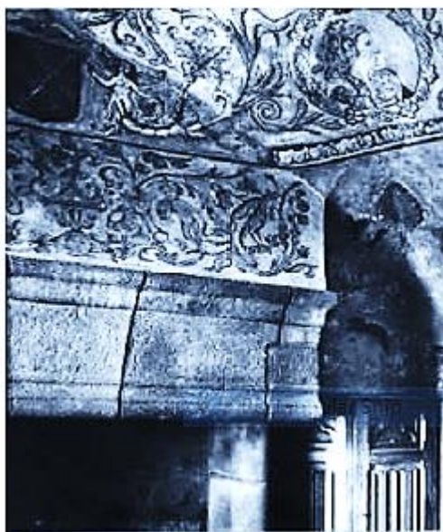
Dégâts causés par les infiltrations près de la cheminée (1952)
